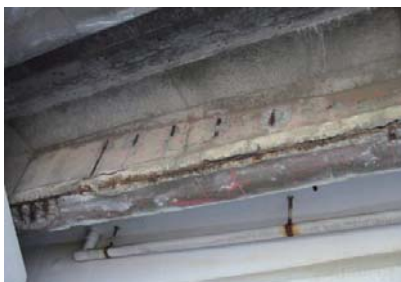
塩害による鉄筋腐食により剥落
