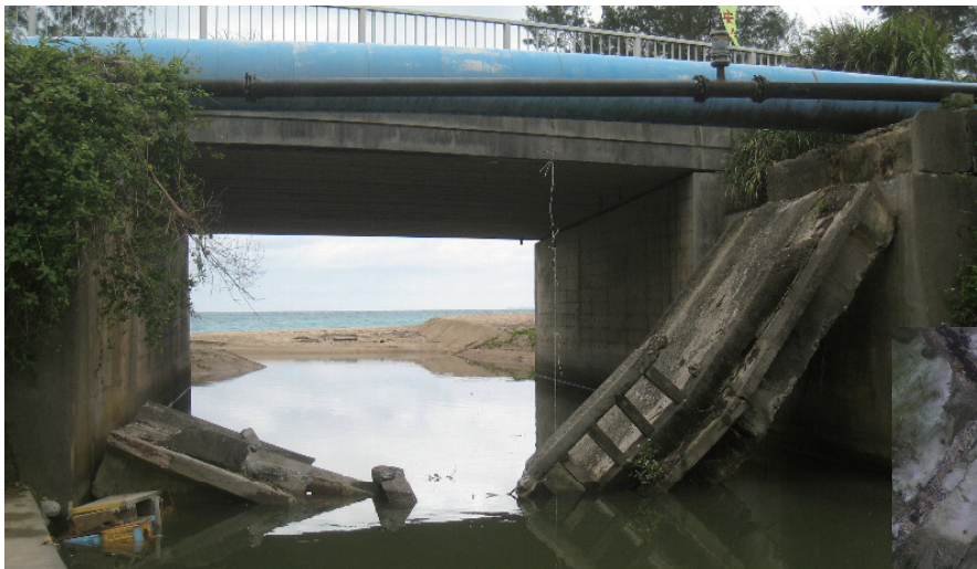
主桁1段目の鉄筋は腐食により消失。2段目鉄筋も露出し、腐食。
