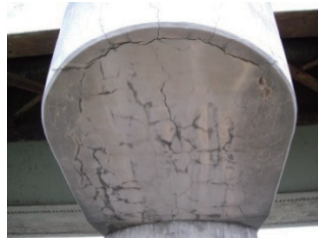
ASRによる損傷
