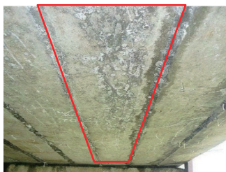
G3桁NO.2 損傷写真-1
