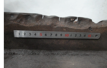
フランジ縁端の応力集中部からの複数き裂の発生
