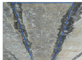
G6桁NO.1 損傷写真-4
