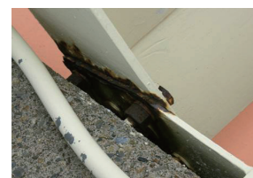
ガセット部の滞水、土砂堆積、腐食事例
