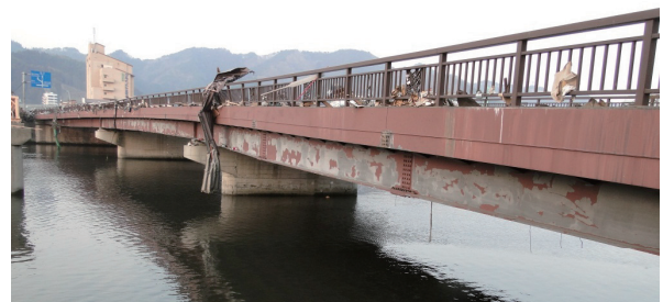
津波により橋桁高さまで浸水したが流出しなかった矢の浦橋(釜石市)
