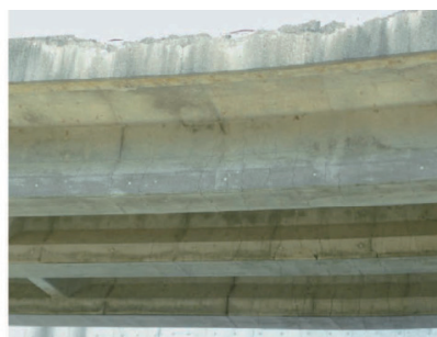
主桁のひびわれ、たわみ
