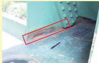
ガセットの局所腐食欠損の例
