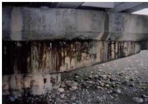
塩害による損傷を受けたRC橋脚
