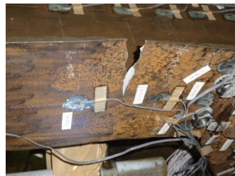
最小断面で破壊が進展
