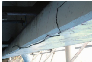
塩害による損傷を受けた主桁
