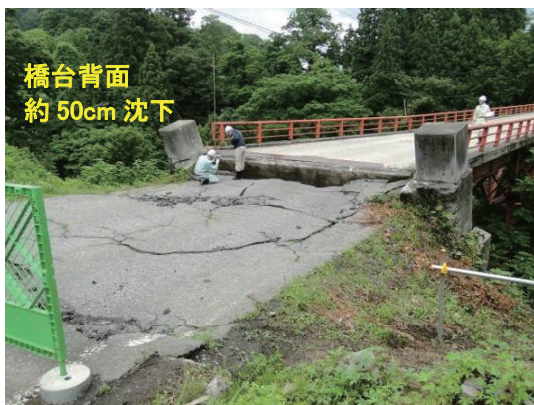
橋台周辺の土塊の沈下と橋台等の傾斜
