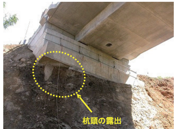
斜面上の基礎における前面地盤の流出
