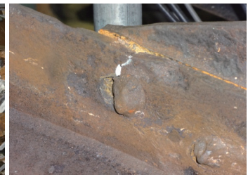
第一リベット孔引き部での部分破断
