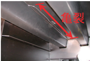
鋼床版で発見された亀裂
