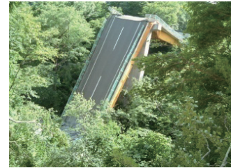
地震による落橋
