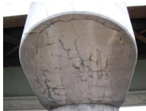
ASRによる損傷
