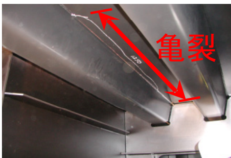
鋼床版で発見された亀裂
