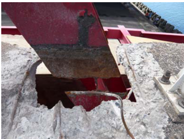
鋼トラス斜材の破断(2007年, 国道23号木曽川大橋)
