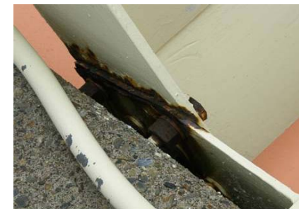
ガセット部の滞水、土砂堆積、腐食の事例
