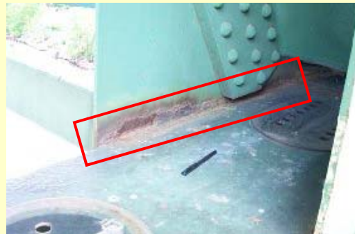
ガセットの局所腐食欠損の例
