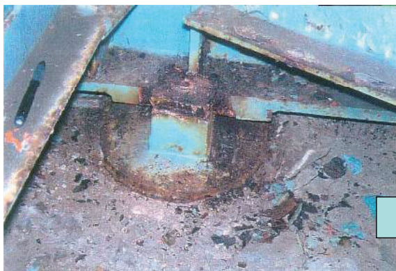
腐食が進行した線支承
