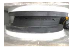
免震支承の亀裂
