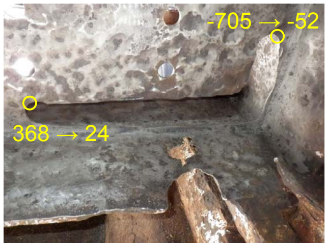
ひずみの状況
