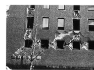
柱のせん断破壊
