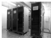
サーバラック (情報通信室)
