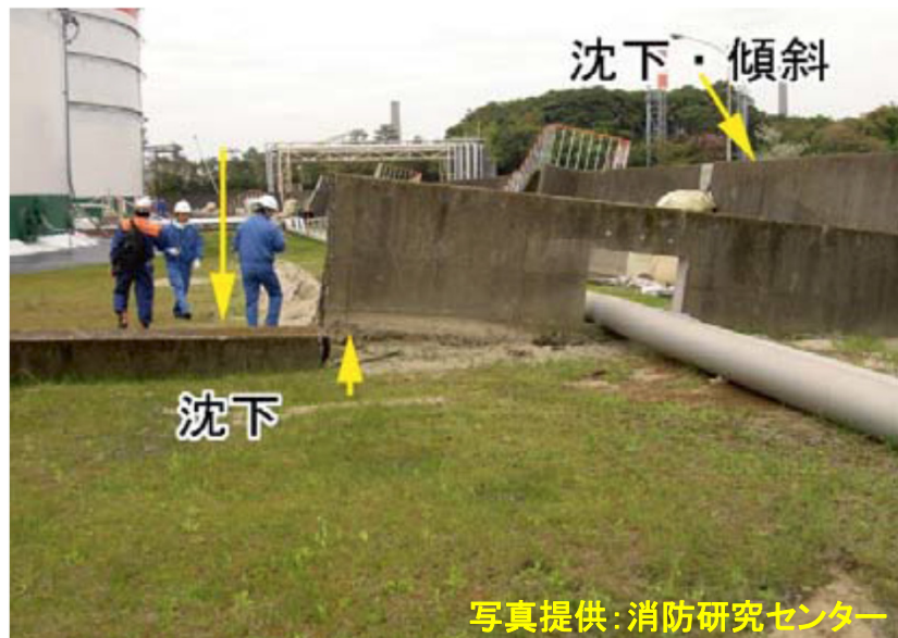
コンビナート地区の液状化被害 (東日本大震災)
