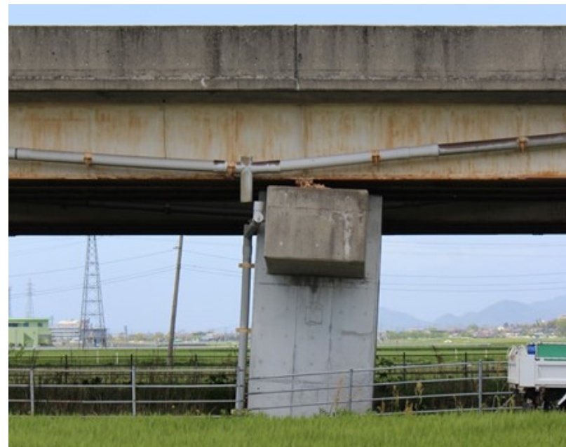
高速道路の橋脚の傾斜(熊本地震)
