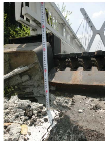
写真-3 A2橋台伸縮装置の損傷と段差
