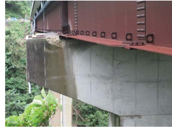
写真-4 ゴム支承の破壊 (P2橋脚)
