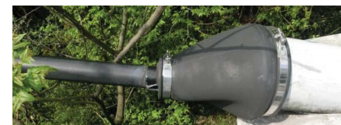
写真-4 ケーブルの損傷
