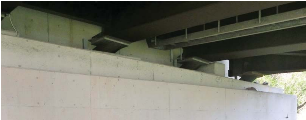
写真-2 A2橋台ゴム支承の残留変形
