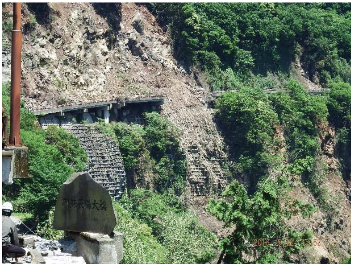
写真-3 斜面崩壊と橋梁の流出
