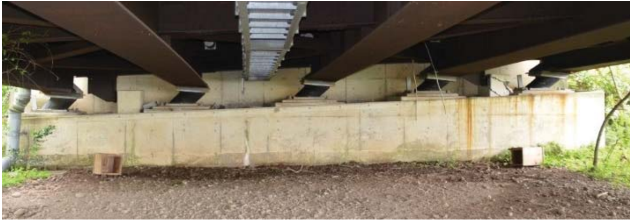
写真-1 A1橋台ゴム支承の残留変形と ジョイントプロテクターの損傷
