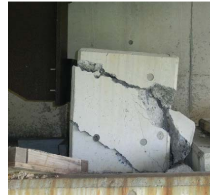
写真-4 A1橋台の横変位 拘束構造の損傷
