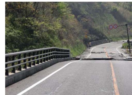
写真-2 A1-P1間での上部構造の屈折
