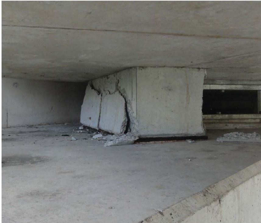
写真1 アンカーボルト定着部の損傷
