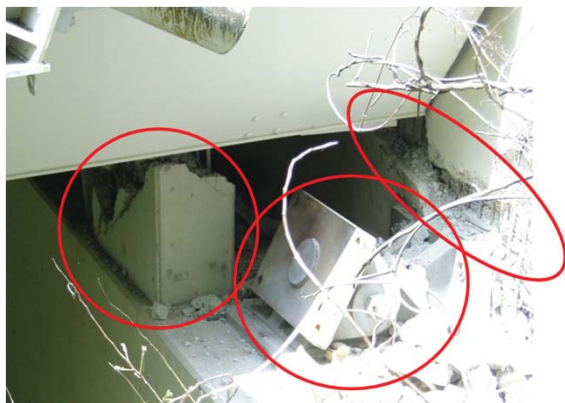
写真-2 A2橋台支承、変位制限構造、パラペットの損傷
