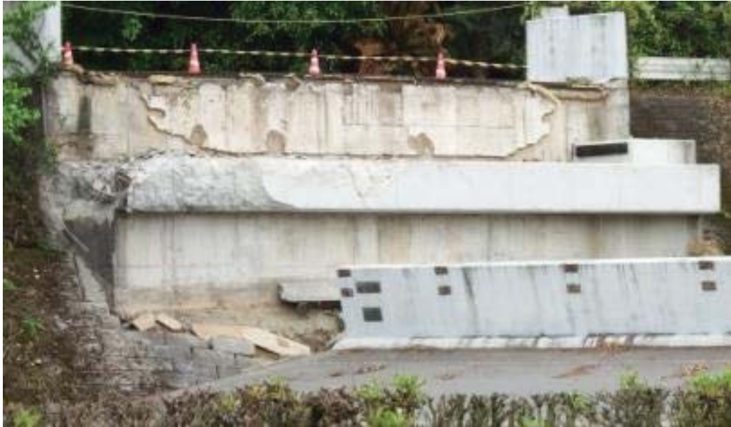
写真-2 A1橋台の損傷
