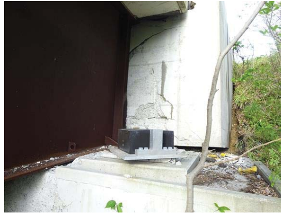
写真-2 A2橋台パラペットの押し込まれ、 支承部の破壊
