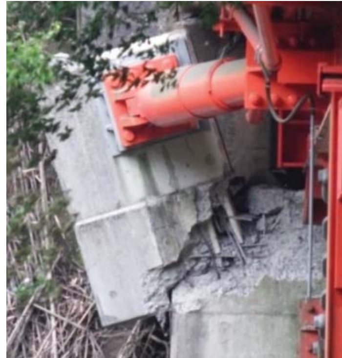
写真2 ダンパー取付部の損傷
