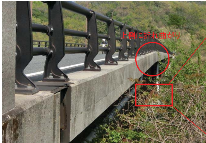
写真-3 A1-P1間での主桁の座屈
