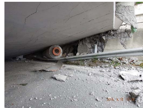
写真-4 ロッキング橋脚の脱落・転倒
