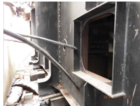
写真-4 落橋防止ケーブルの破断
