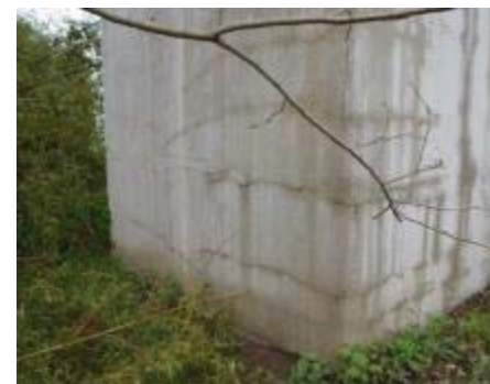
写真-5 P2橋脚のひび割れ
