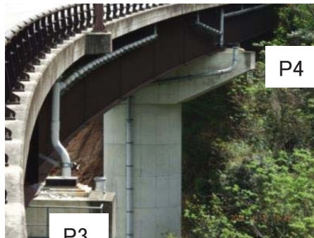
写真-3 桁の残留変位
