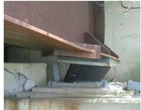
写真-3 A1橋台ゴム支承上 の下フランジの変形
