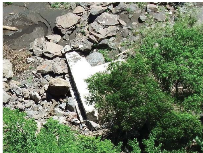
写真-4 橋脚の流出
