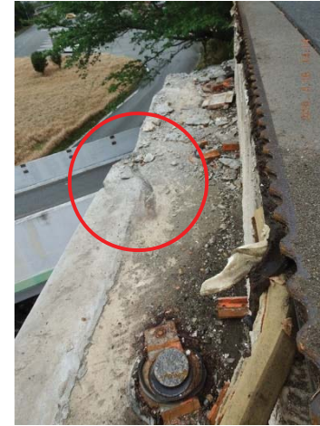
写真-3 斜角側橋座部に残された擦過痕
