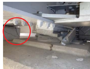
写真-4 支承の破損の状況
