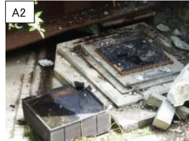
取り付けボルトが破断
