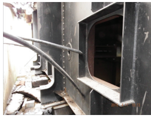
写真-4 落橋防止ケーブルの破断
