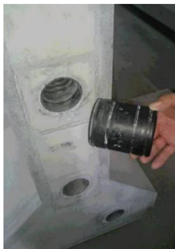
カプラーシースの状況
