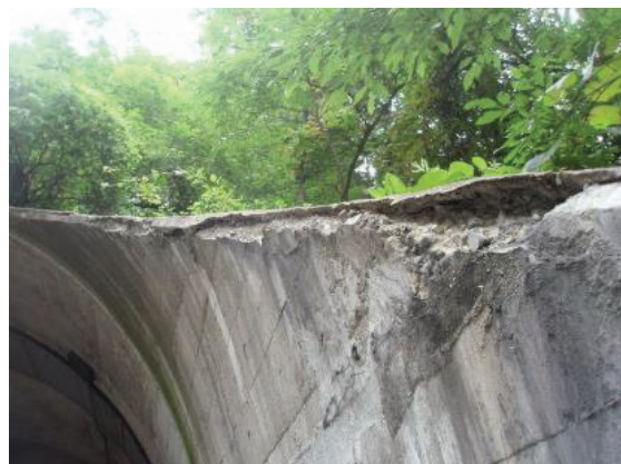
トンネル坑門工の凍害
