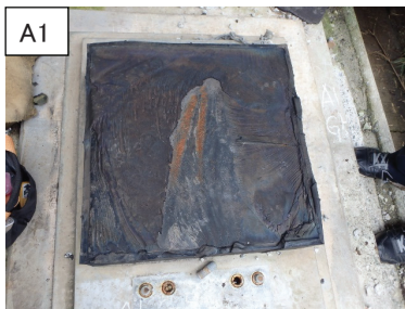
ゴム部分又は接着層が破断
