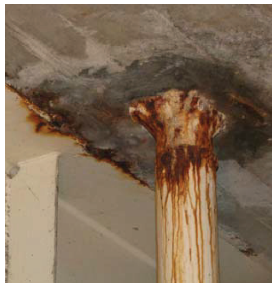
排水柵周辺からの漏水
