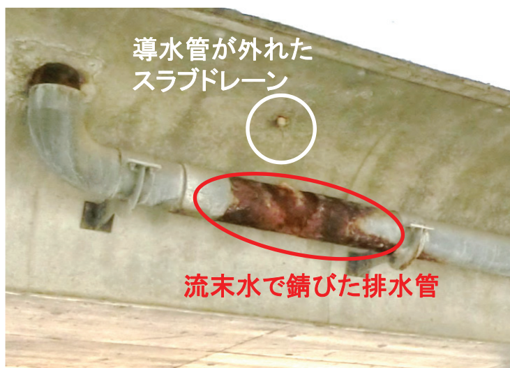
スラブドレーンの流末水で排水管が腐食
