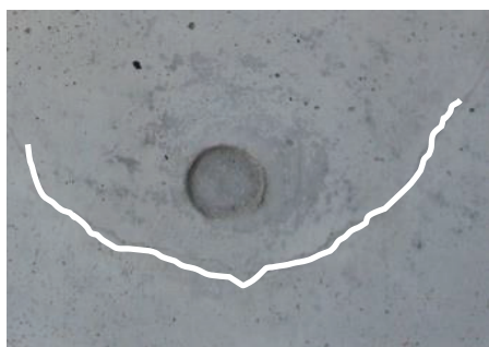
沈みひび割れ
