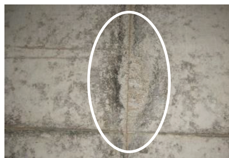
型枠継目のノロ漏れ
