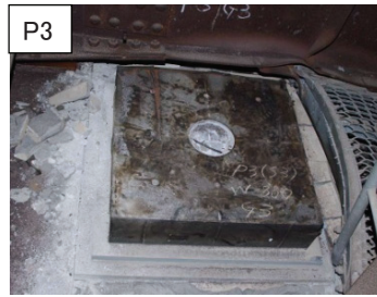
取り付けボルトが破断
