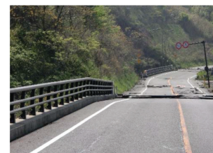
写真-2 A1-P1間での上部構造の屈折
