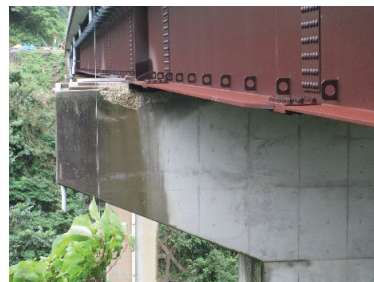
写真-3 ゴム支承の破壊 (P2橋脚)
