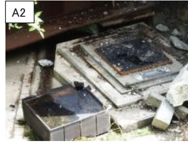
取り付けボルトが破断
