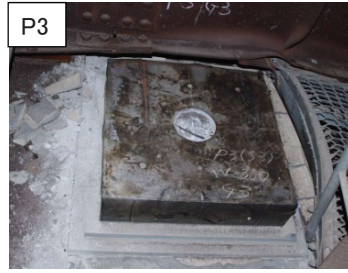
取り付けボルトが破断
