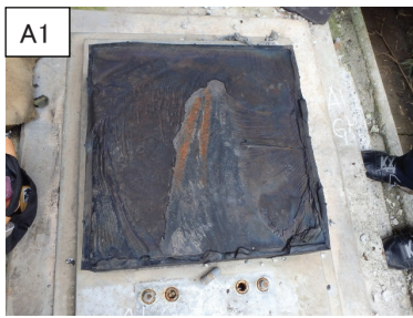
ゴム部分又は接着層が破断
