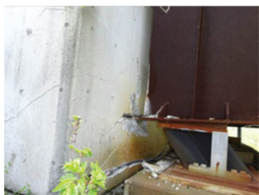
写真-1 A1橋台と桁の衝突、 支承の残留変形
