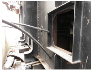
写真-4 落橋防止ケーブルの破断
