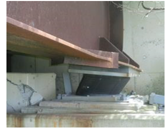
写真-2 A1橋台ゴム支承上 の下フランジの変形
