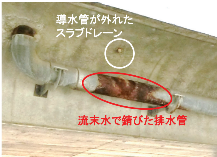
スラブドレーンの流末水で排水管が腐食
