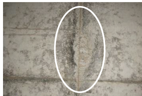
型枠継目のノロ漏れ
