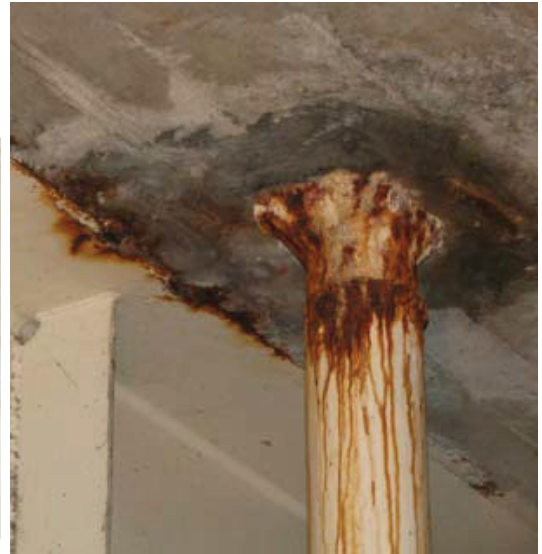
排水柵周辺からの漏水
