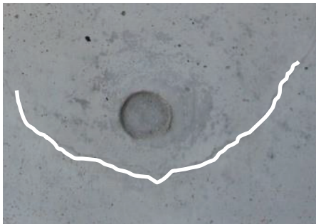
沈みひび割れ
