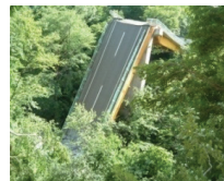
地震による落橋
