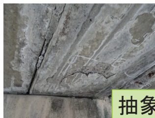
床版にひび割れ 遊離石灰がある
