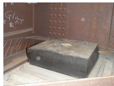
支承取付け ボルトの損傷
