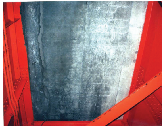
B橋のRC床版下面状況
