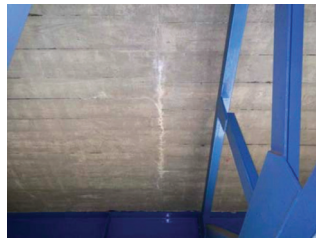
床版に遊離石灰がある
