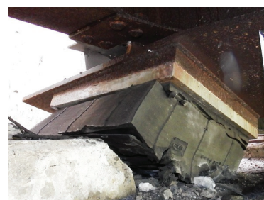
ゴム支承本体 の損傷
