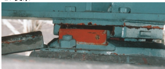
サイドブロック取付けボルトの損傷
