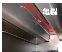
鋼床版で発見された亀裂
