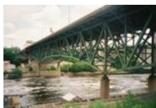
（出典：NTSB Highway Accident Report, Collapse of I-35W Highway Bridge）
