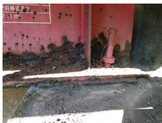
桁端が腐食している
