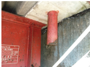
排水口が腐食している
