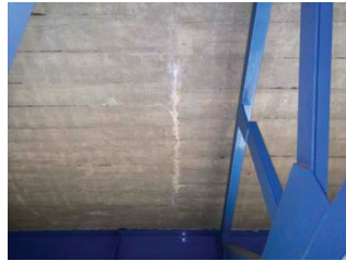
床版に遊離石灰がある
