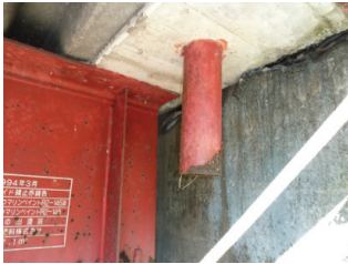
排水口が腐食している
