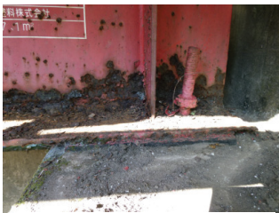
桁端が腐食している
