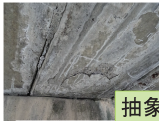
床版にひび割れ 遊離石灰がある
