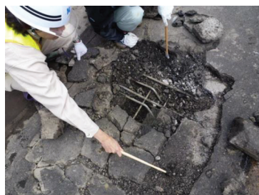
RC床版上面が土砂化している事例
