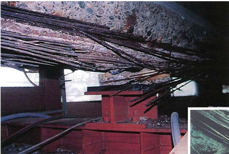
主桁のPC鋼材の破断している状況
