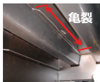
鋼床版で発見された亀裂
