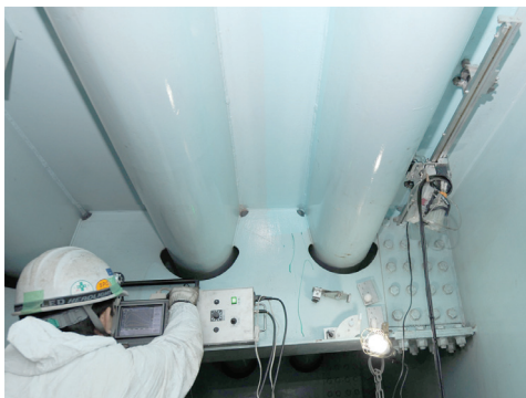
超音波探傷による鋼床版デッキプレート の疲労き裂の調査方法の開発
