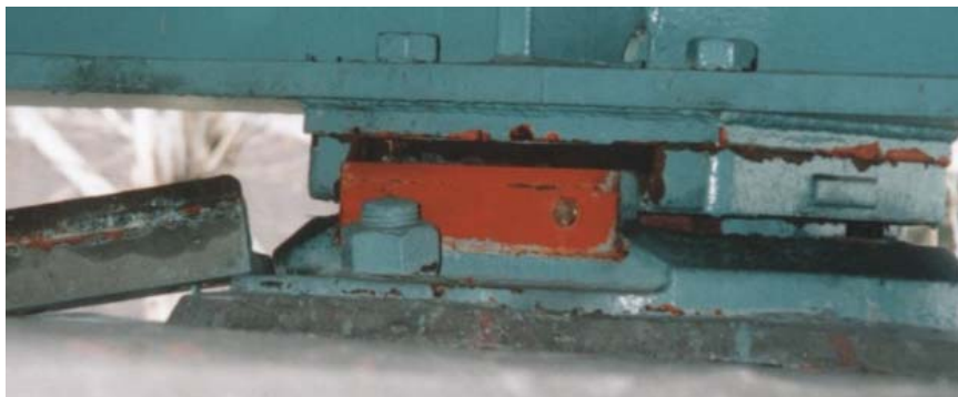
サイドブロック取付けボルトの損傷
