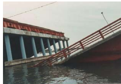
昭和大橋の落橋
