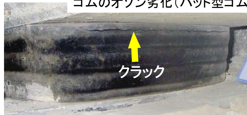
ゴムのオゾン劣化(パット型ゴム支承)
