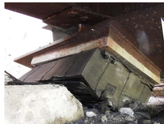
ゴム支承本体 の損傷
