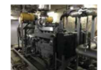
＜自家発電装置＞
