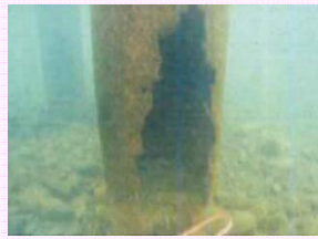
▲橋脚水中部の断面欠損
