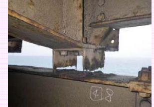
▲シェッド主梁端部破断
