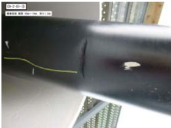
PE被覆の割れ
