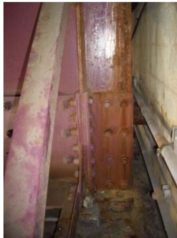
補強後の再腐食
