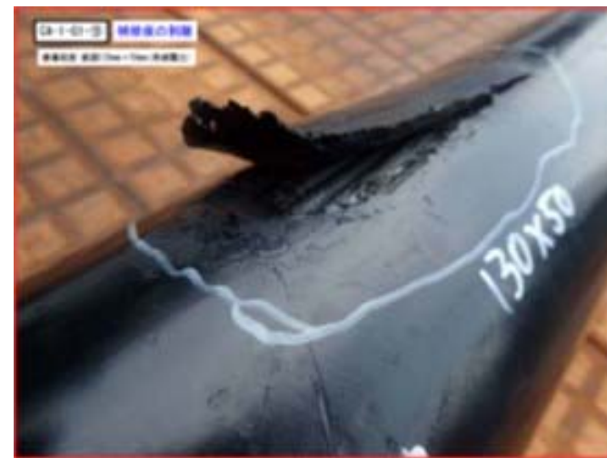
PE被覆の剥離
