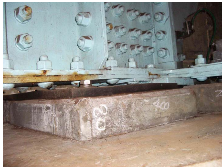
補強後の再腐食
