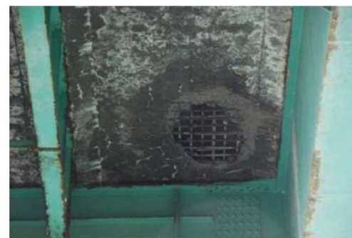
土砂化(砂利化)による損傷
