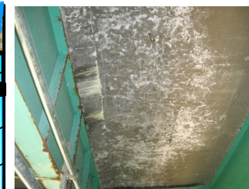
ひびわれ進展 + 白色析出物
