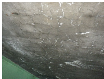
多角形のひびわれ発生
