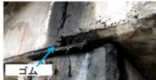
支承の劣化・桁と梁が密着
