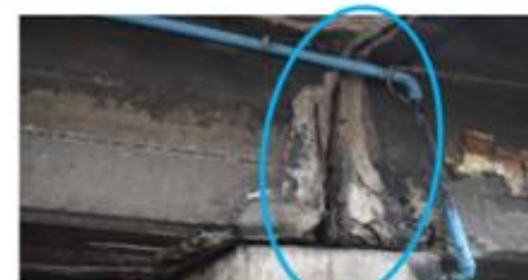
水みち(漏水跡)
