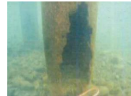
▲橋脚水中部の断面欠損
