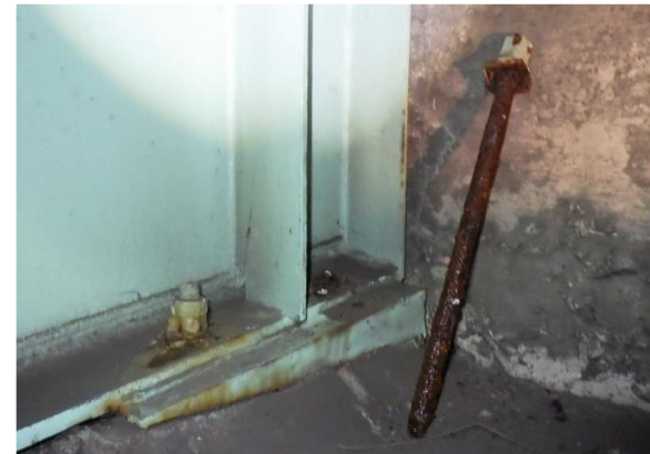
打音、触診により定着不良を確認
