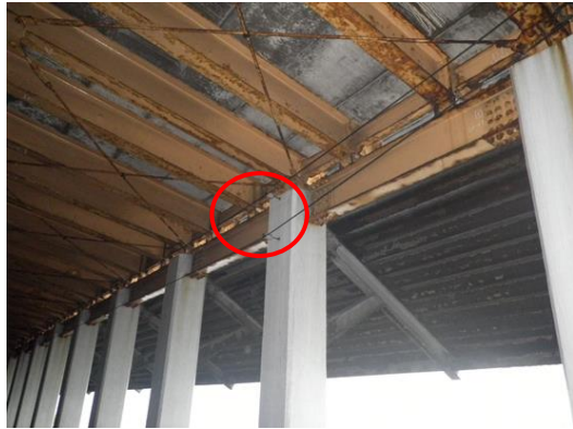
路上からの目視状況(変状箇所の確認は困難)
