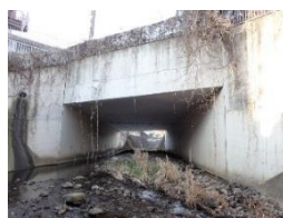
▲水路ボックス
