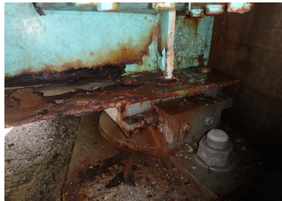
地方自治体管理 主桁腐食
