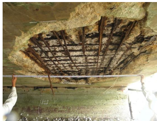
地方自治体管理 床版鉄筋露出
