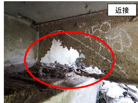
近接目視により断面欠損を確認
