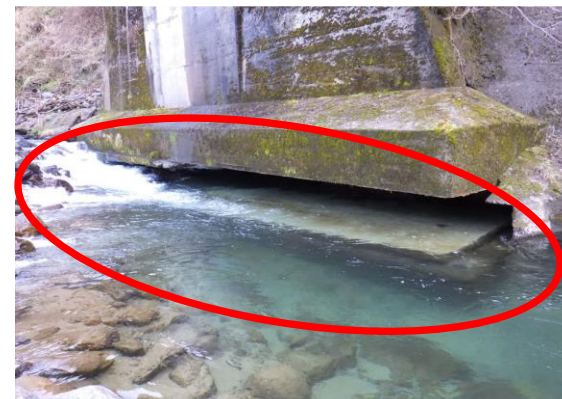
橋台基礎の大規模な洗掘を確認
