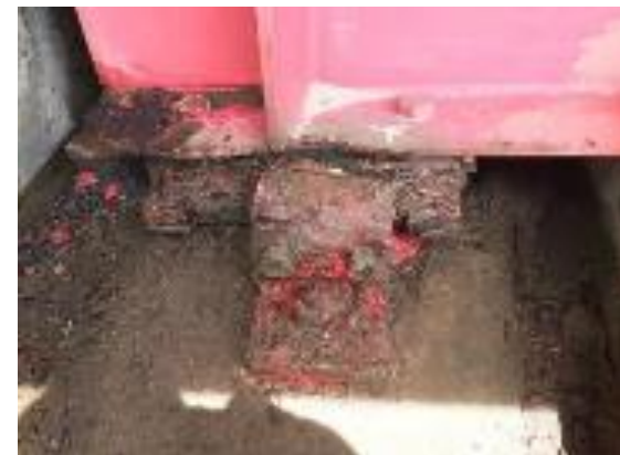
地方自治体管理 支承腐食
