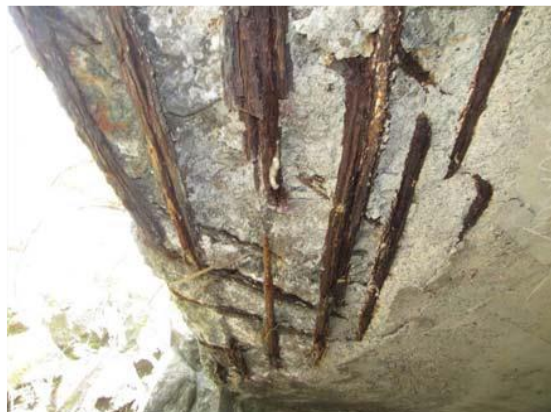
国管理 床版鉄筋露出
