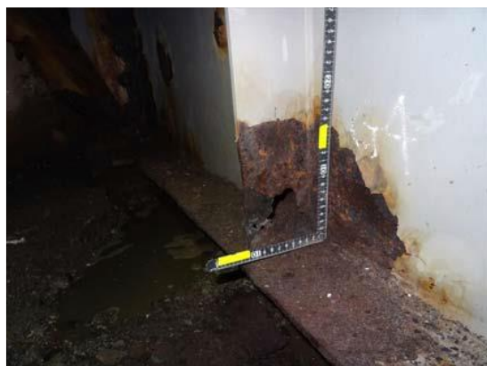
国管理 主桁腐食・欠損
