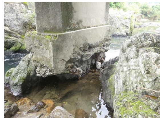
地方自治体管理 橋脚洗掘
