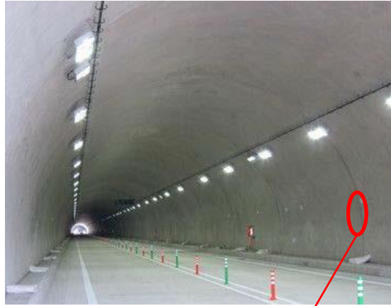
近接目視により確認された「うき」
