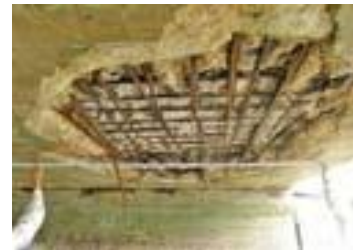
塩害が深刻化し 内部の鉄筋が露出した橋梁
