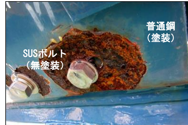
異種金属接触腐食の例
