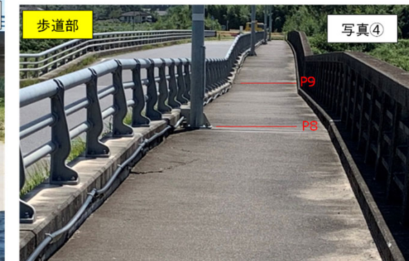
▲歩道部の変形状況(P8→P9方面)
