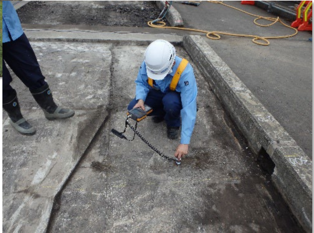
RC床版の土砂化に関する現地調査
