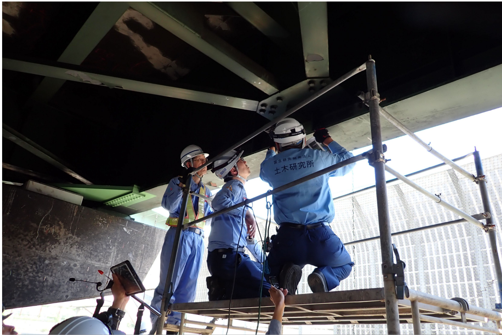
亀裂が生じた鋼橋に関する技術支援
