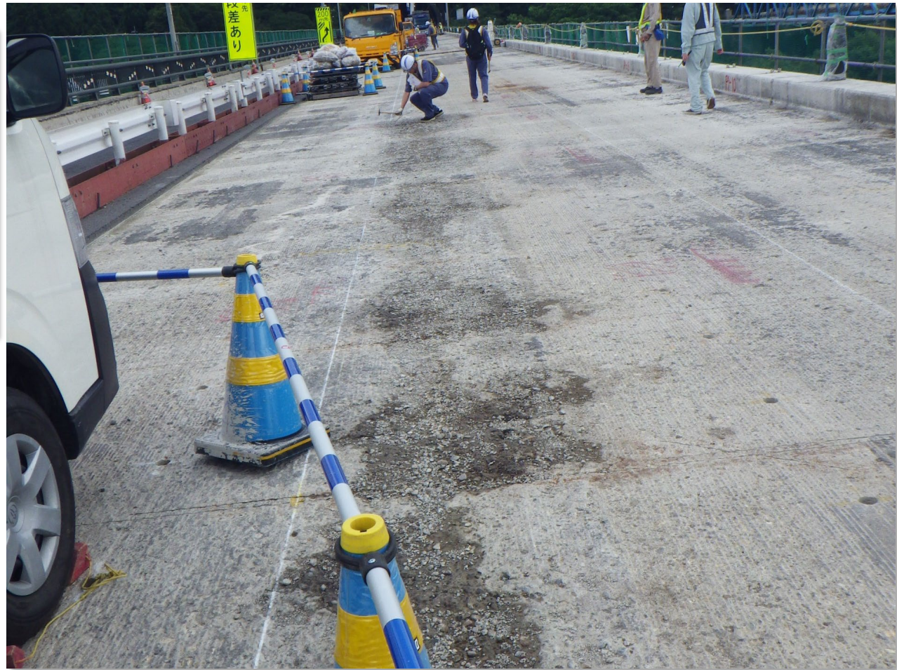
センターライン付近（舗装打継目）での床版土砂化
