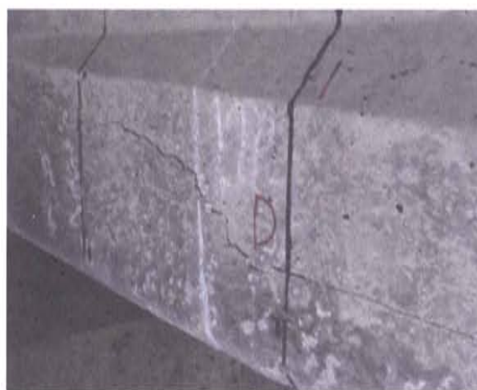
図-3.5 富山側海面の下フランジの浮き
