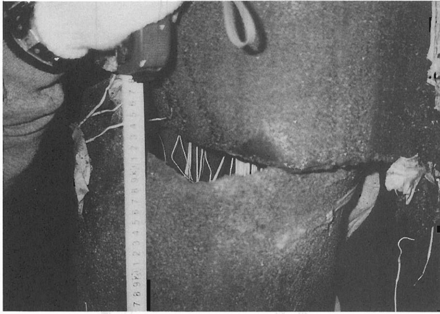
写真-4-1 鋼管杭（ケース2）の損傷状況
