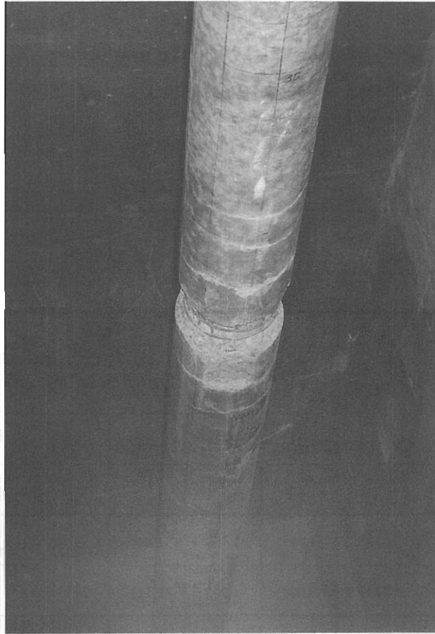
写真-参-17 杭体損傷状況③（ケース4：PHC杭コンクリート除去後）
