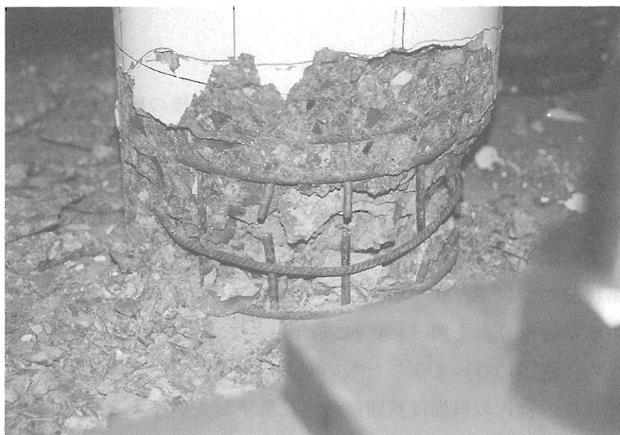
写真-3.4.1 杭①下部の損傷状況（ケース4、実験終了後）
