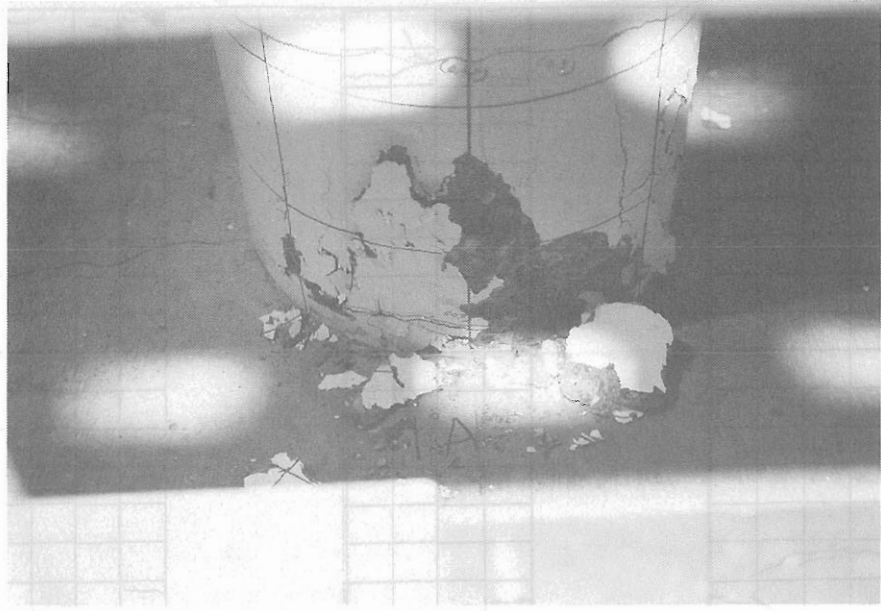
写真-3.4.2 杭①下部の損傷状況 (ケース4、 4\delta y )
