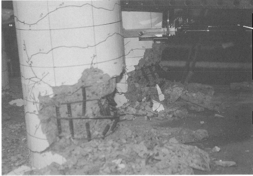
写真-3.2.4 杭①下部の損傷状況（ケース2、実験終了後）
