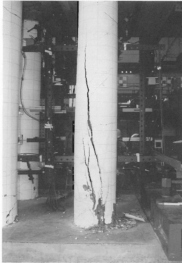
写真-3.3.2 杭①下部の損傷状況（ケース3、4 \delta y ）
