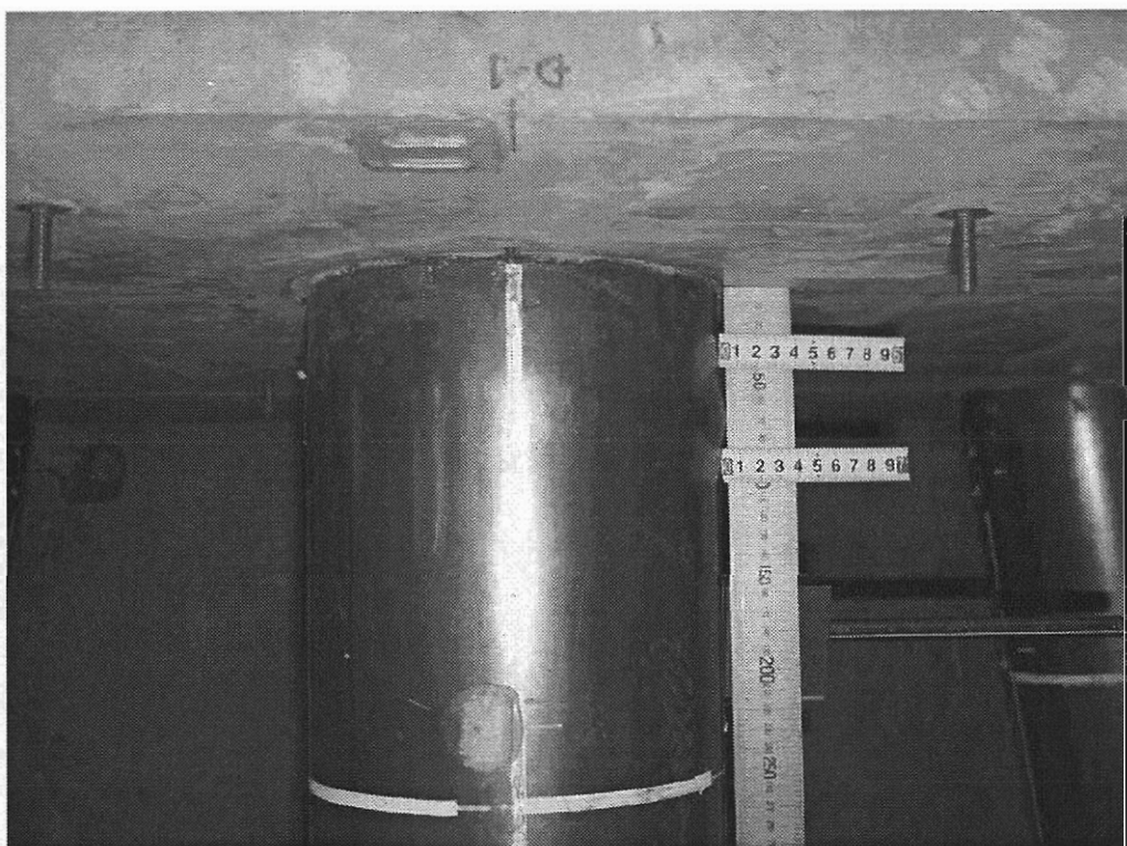
写真- 3.1.4 3列供試体 杭頭部損傷状況(直杭/中間杭、試験終了時)
