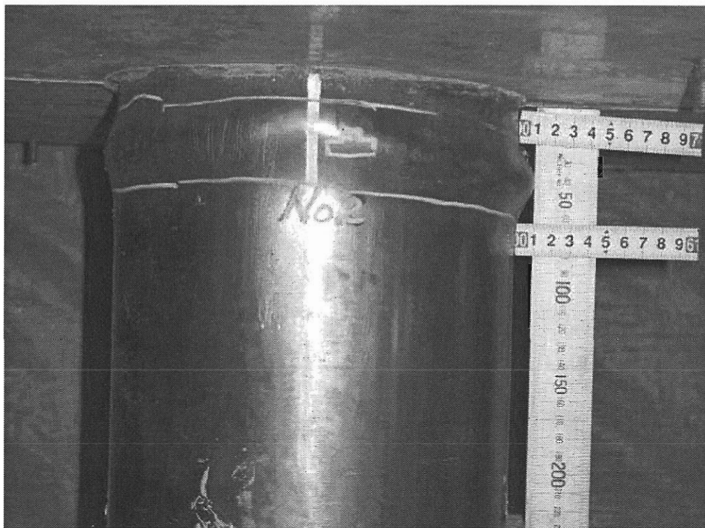
写真- 3.2.4 4列供試体 杭頭部損傷状況(直杭/中間杭、試験終了時)
