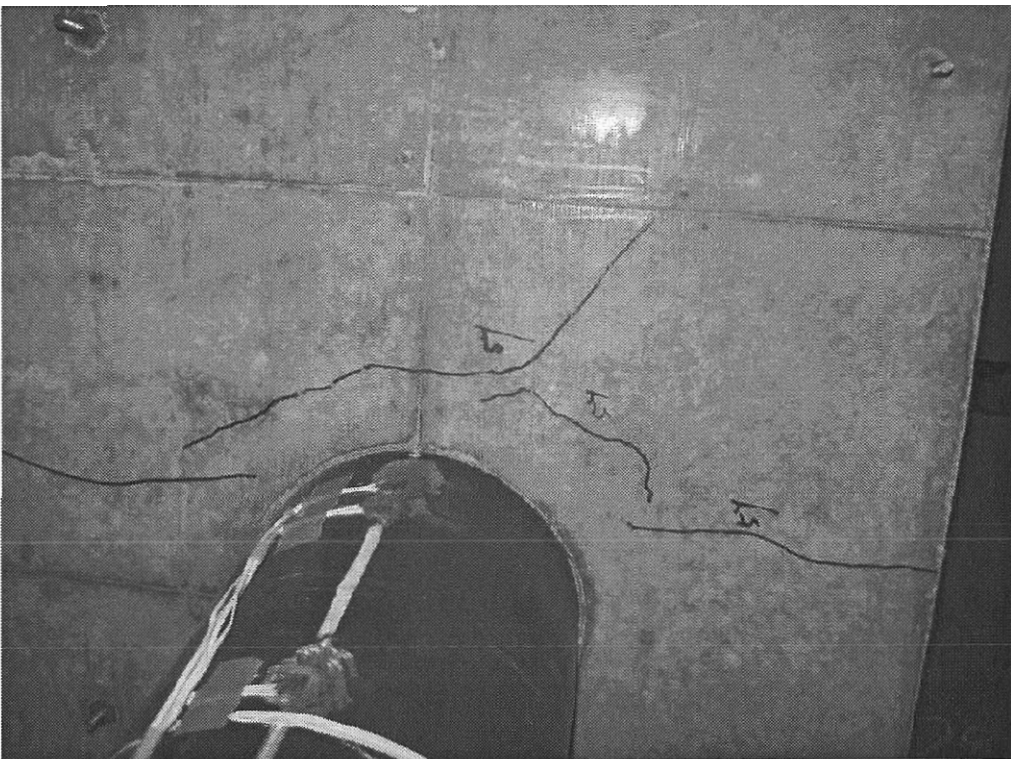
写真- 3.1.2 3列供試体 上フーチング底面ひびわれ状況(試験終了時)
