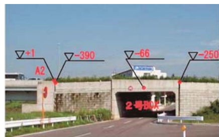
写真-3 A2側橋台背面の沈下
