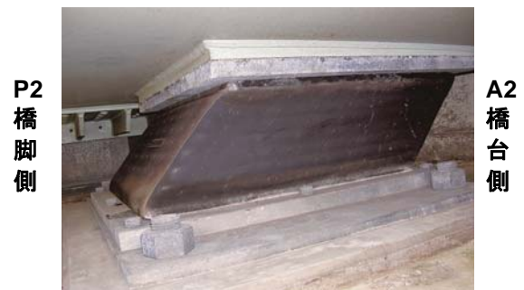
写真-2 A2橋台上のゴム支承の変形
