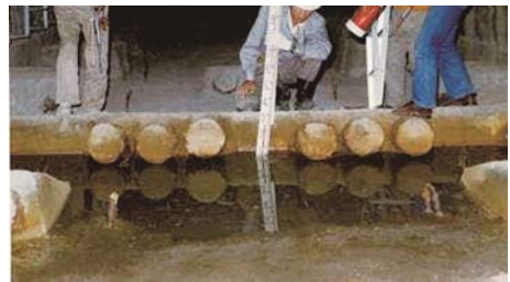
写真-2 箱桁内、桁端部付近のPC定着部と滞水状況
