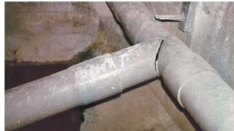
写真-3 箱桁内の排水管継手の割れと滞水
