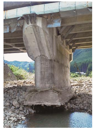
写真-2 洗掘状況
