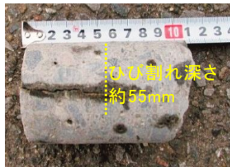
写真-5 コアによるひび割れ深さ
