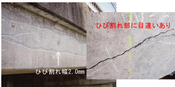
写真-1 PC桁側面のひび割れ状況
