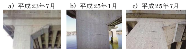
写真-3 橋脚柱頭部のひびわれの進展
