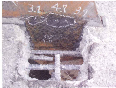
図-2 床版はつり調査
