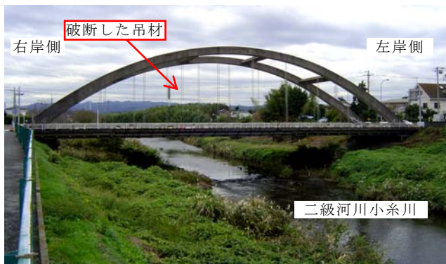
写真-1 橋の外観と吊材の破断位置
