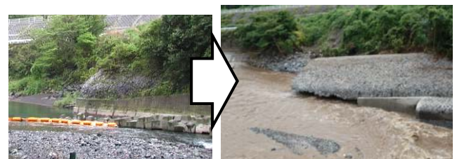
写真-3 増水による水制工の洗掘被害の状況
