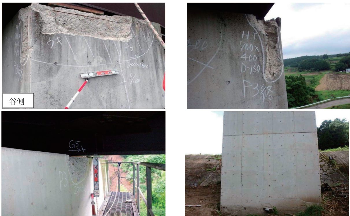
写真-2.3.14 橋脚の損傷状態
