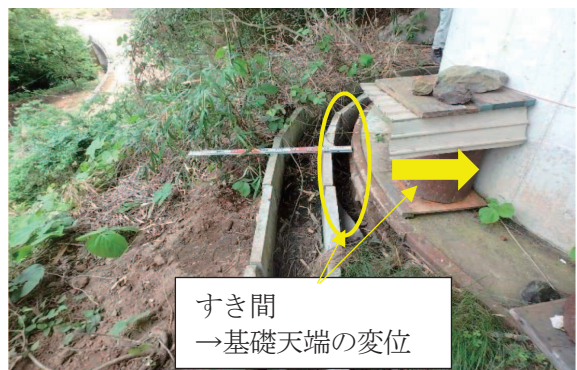
写真-2.3.9 基礎天端の変位
