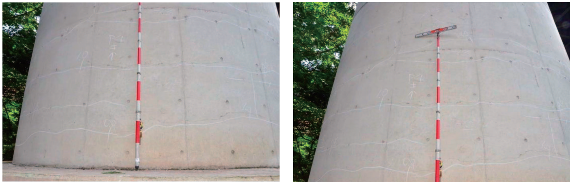
写真-2.3.16 P4 橋脚の損傷状態
