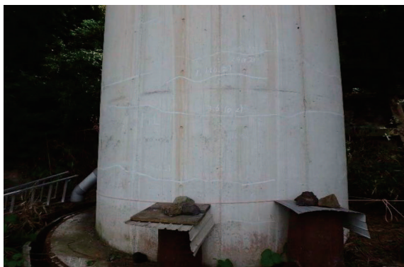
写真-2.3.8 橋脚の損傷状態(起点側)
