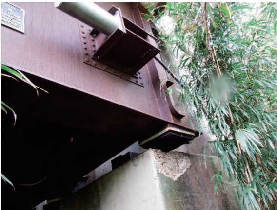
(a) G1 の落橋防止ケーブル
