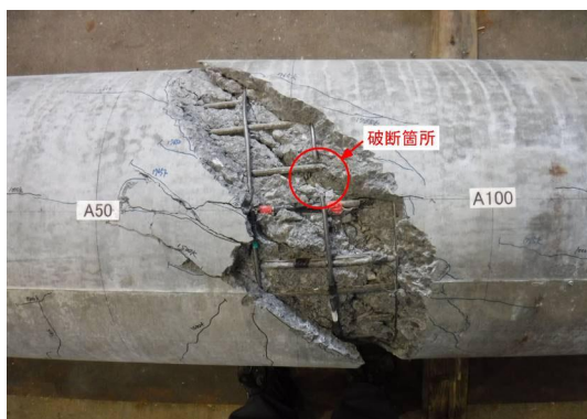
(a) せん断ひび割れ箇所全景 (A側側面)
