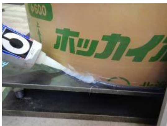
付写真-2. 2. 39 底板側 BP 溝部のシーリング
