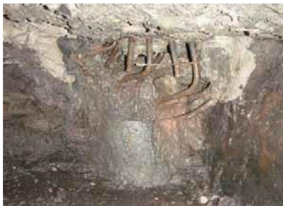
写真-5. 1. 1. 1 既製コンクリート杭基礎のせん断破壊被災事例（西川橋） 2)
