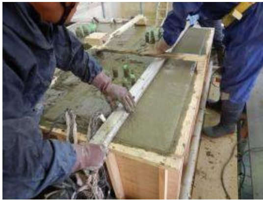
付写真-4. 2. 158 コンクリートのすり切り
