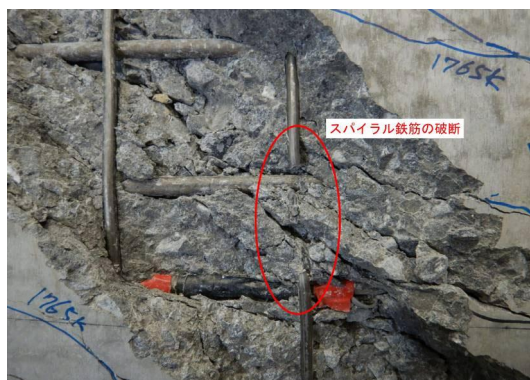
(b) スパイラル筋破断箇所拡大
