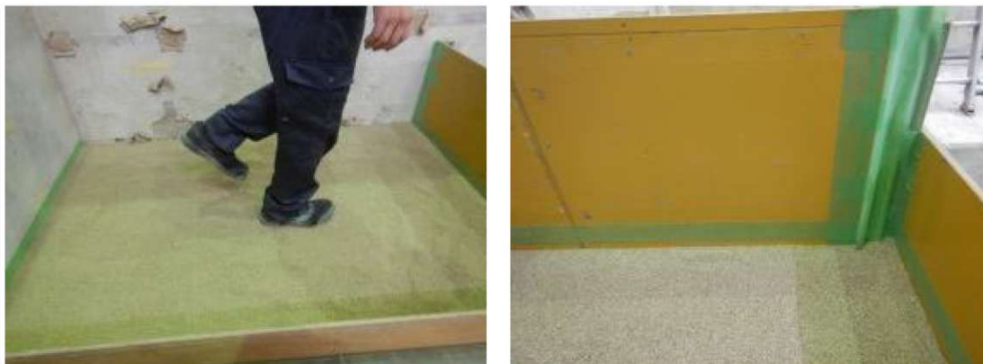
付写真-4. 2. 168 施工者の踏み固めによる地盤の沈降
