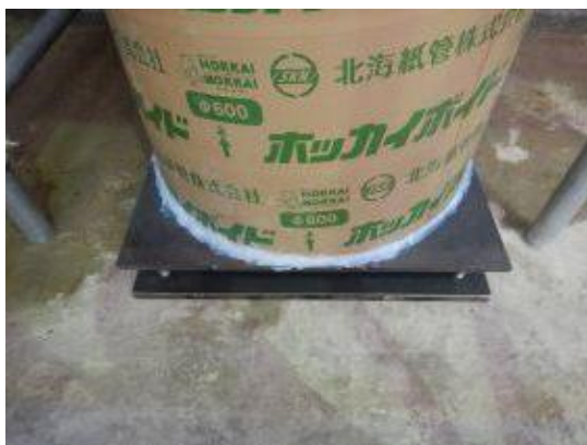
付写真-3.1.30 底板側 BP 溝部のシーリング
