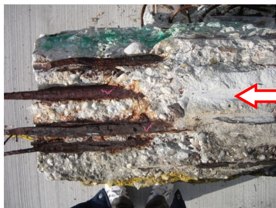
露出した鉄筋
