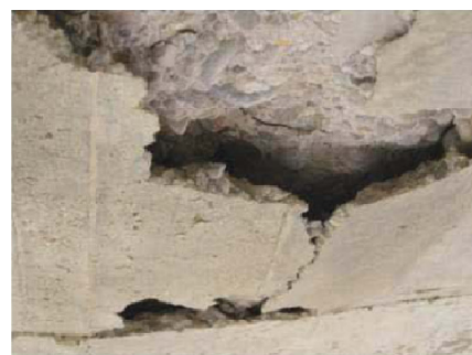
床版下面の剥離
