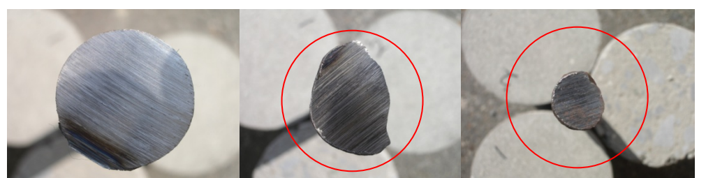
Φ25程度 比較的健全な鉄筋
