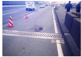
路面陥没の事例
