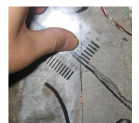
せん断ひび割れ幅 約1.7mm
