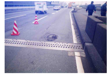
路面陥没の事例
