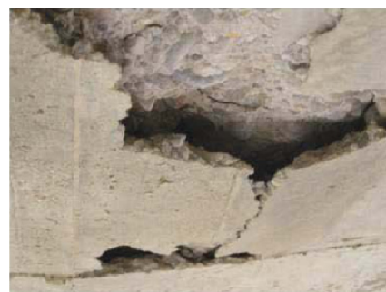
床版下面の剥離
