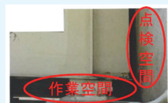
点検スペースが確保されていない
