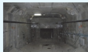
追加ケーブル設置の困難さ
