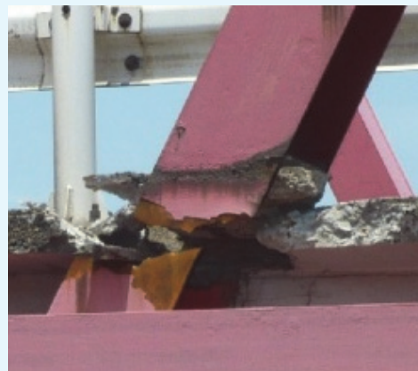
木曽川大橋のトラスの破断
