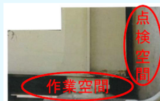
点検スペースが確保されていない
