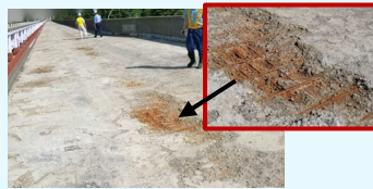
舗装の下で進行する床版の土砂化
