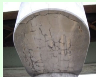
アルカリシリカ反応による損傷
