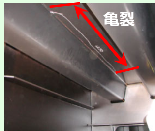
鋼床版で発見された亀裂
