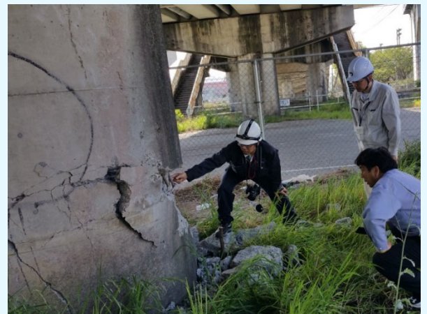
熊本地震における道路橋の被災調査
