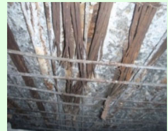
コンクリート橋におけるPC鋼線の破断
