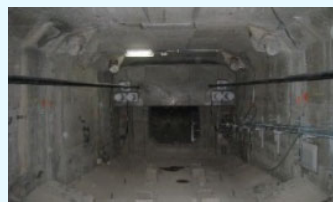
追加ケーブル設置の困難さ
