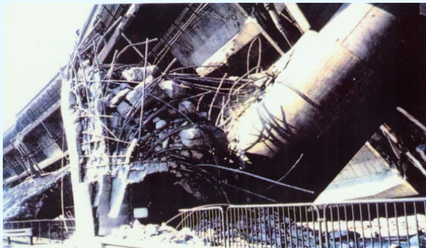
1995年兵庫県南部地震における阪神高速3号神戸線の倒壊
