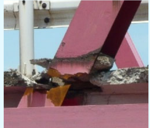
木曽川大橋のトラスの破断
