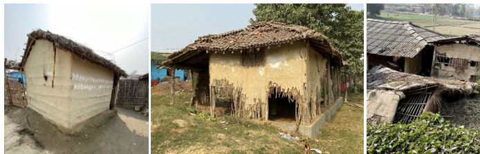
写真 3-14 洪水による被災家屋の様子
