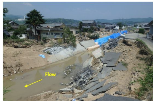
写真 2 末政川の破堤(倉敷市真備町)
