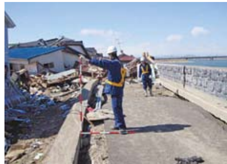
特殊堤の被災状況の調査
