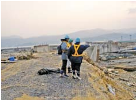
津波により被災した道路橋の調査
