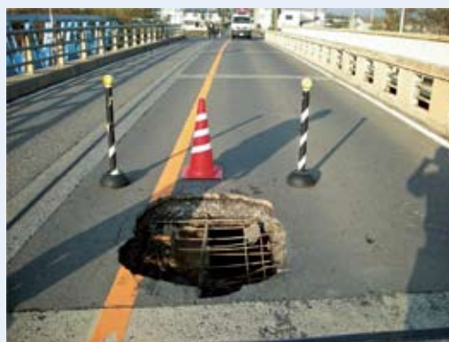
供用中における重大損傷事例
