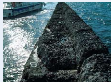
写真－1 スケーリング被害例
