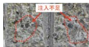
室内実験による注入不足の一例
