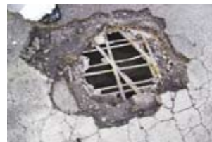
陥没が生じたRC床版
