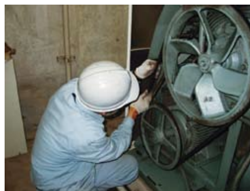
〔三次元大型振動台用の空気圧縮機〕
