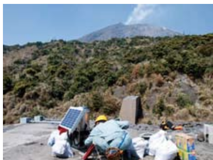
【H20.3 自動降灰量計の設置】
