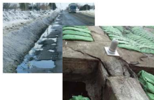
写真-2 凍上や融雪水による損傷（道路舗装・コンクリート法枠）
