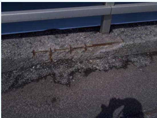
写真-1 スケーリング
