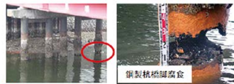
■見晴橋（市道 新山下第8号線）は、37歳で損傷を発見
