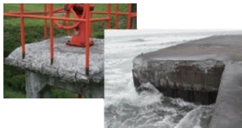
写真-1 凍害や塩害・摩耗との複合劣化（樋門・沿岸構造物）
