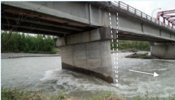
写真-1 橋脚の沈下・傾斜（清水町共栄橋）
