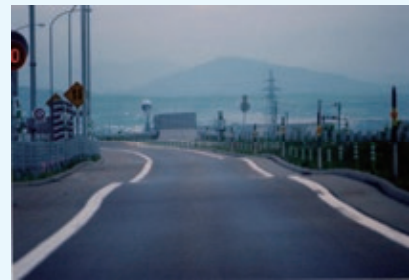
写真-1 泥炭性軟弱地盤上の道路の沈下
