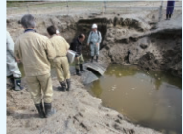
写真-1 用水管の離脱状況
