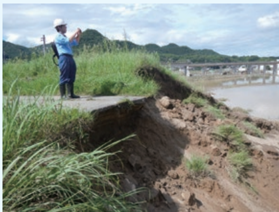
写真-3 小田川堤防決壊箇所の確認
