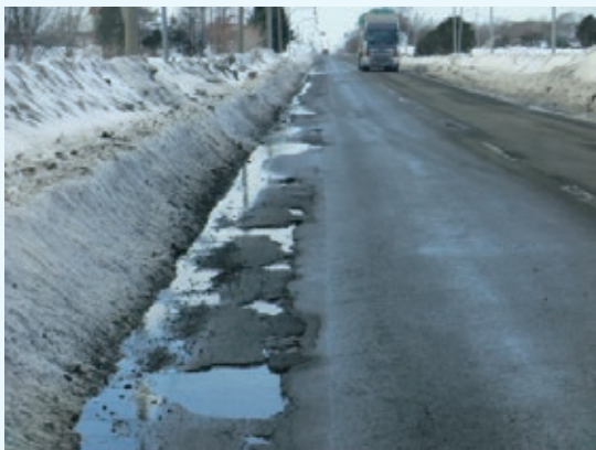
写真-1 ポットホール発生状況
