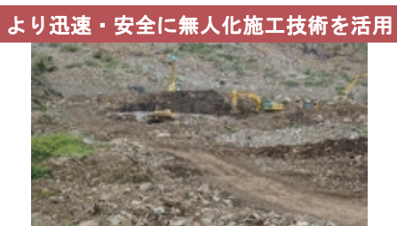
(阿蘇大橋地区斜面防災工事) 図-4 土砂災害の防止・軽減のために開発するロボット技術
