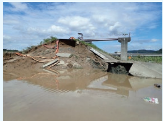
写真-2 小田川左岸 6.4k 地点の被災状況
