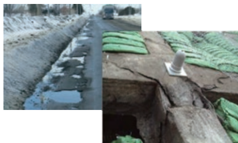
写真-2 凍上や融雪水による損傷（道路舗装・コンクリート法枠）
