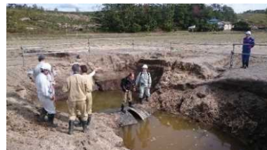
写真-1 地震災害における農業用管水路の継手部離脱による漏水事故の状況
