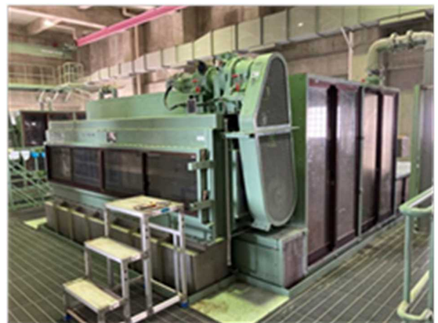
図-6 実証を行ったベルトプレス脱水機
